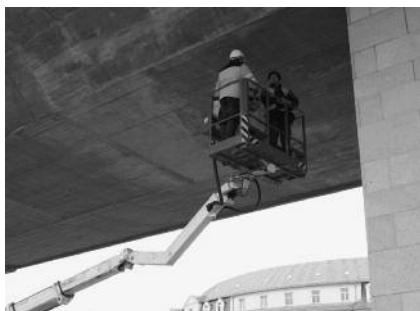
Nur durch regelmäßige Bauwerksprüfungen lässt sich die Standsicherheit von Brücken gewährleisten und deren infrastrukturelle Netzfunktion erhalten.
