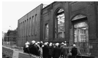
Der Baustart für das „tjg. theater junge generation“ und die Staatsoperette erfolgte am 14. April 2014 im 175 Jahre alten Kraftwerk Mitte.
